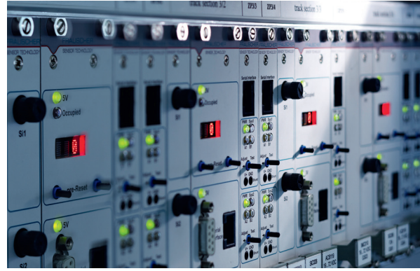
Sistema de contador de ejes ASC2000
