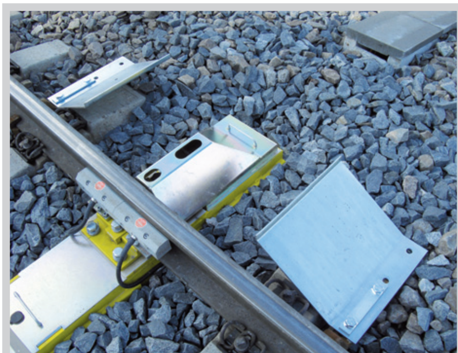
Bild 8: Über Radsensoren angesteuerte Heißbläuerortungsanlage
